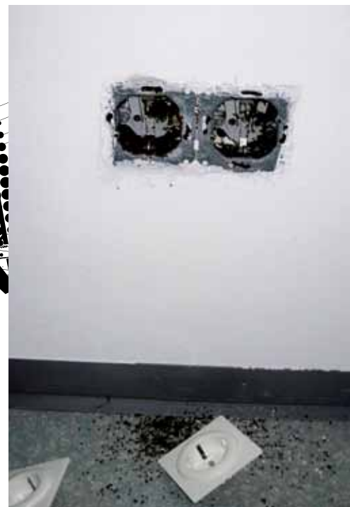
Abb.3 Steckdose mit Ameisenbefall (© Archiv Schädlingsbiologie Scholl+Partner)
